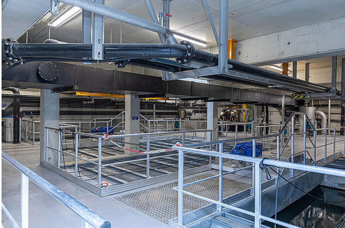
La station d'épuration de la Salis
